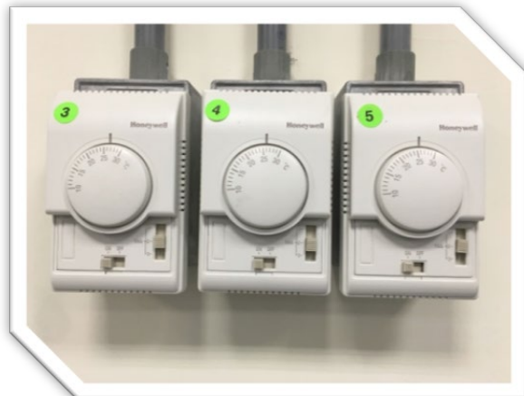
空調採用恆溫裝置
